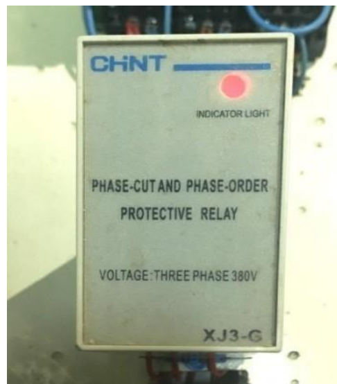
Gambar 5. Phase Failure Rele saat Kehilangan Tegangan Satu Fasa
