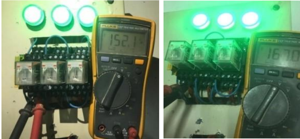
Gambar 4. Pengukuran Tegangan pada Coil rele 1 saat Kehilangan Tegangan Satu Fasa
